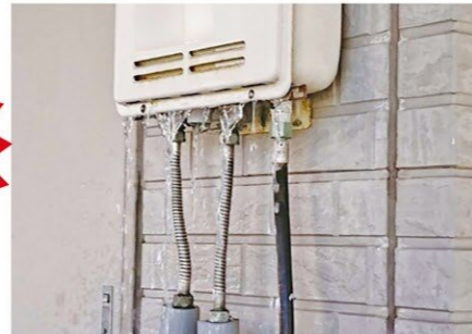
水抜きを忘れて破裂した湯沸器
