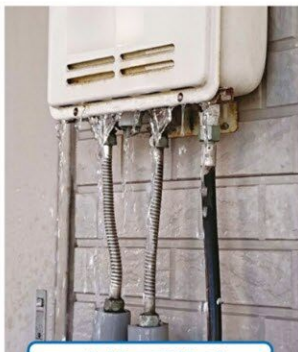
内部の配管が破損した給湯器
