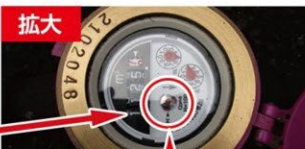
回転していたパイロットが止まり、止水が完了したことを確認できます。
