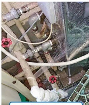
破損した給湯器周りの配管
