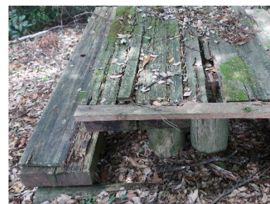
■劣化したテーブル（箭山神社付近）
