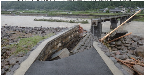
【中津市耶馬溪町 市道岩屋中川原線崩壊の状況】
