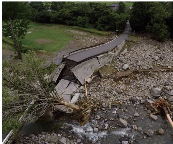
【中津市山国町 市道庄屋村線崩壊の状況】
